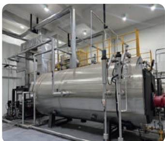
▲鍋爐系統導入廢熱回收裝置
