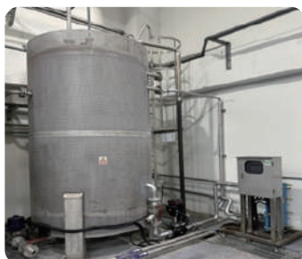
▲鍋爐系統導入廢熱回收裝置
