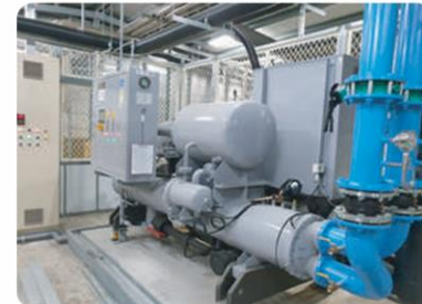
▲I棟新冰水主機
