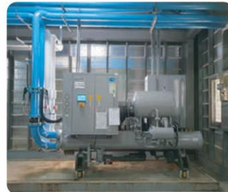
▲B棟新冰水主機
