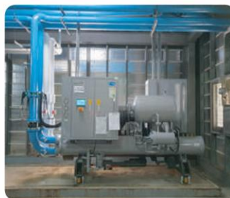
▲B棟新冰水主機
