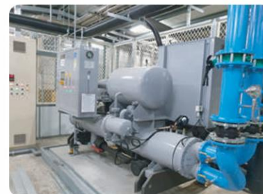
▲I棟新冰水主機
